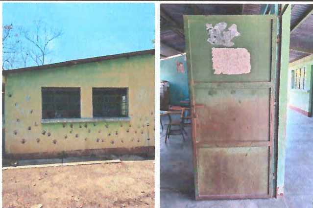
Foto 3: Necesidad de remozamiento en pintura del establecimiento
